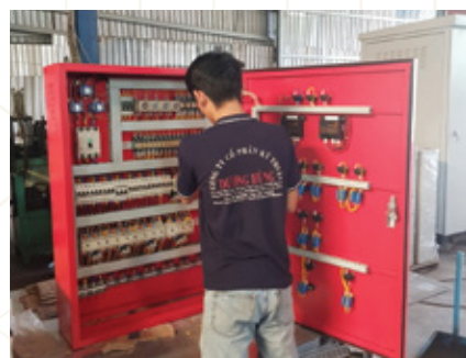
TỦ ĐIỀU KHIỂN
