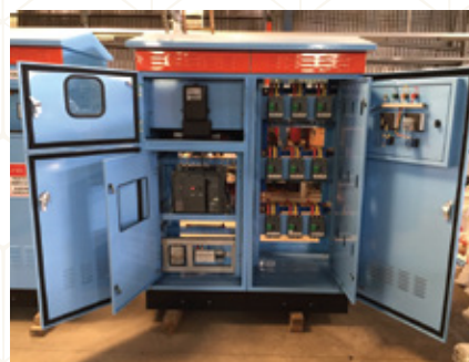
TỦ SOLAR MSB
