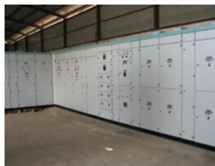
HỆ THỐNG TỦ MSB
